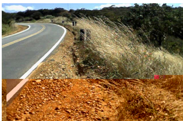
Foto 2 - Ausência de canaletas de drenagem pluvial laterais na BR-430 causando erosão em sulco na margem direita da pista. A voçoroca está a 4m desta margem. O escoamento concentrado ocorre de maneira mais intensa nos locais de declives mais acentuados, devido o desnudamento das vertentes. As características litológicas
